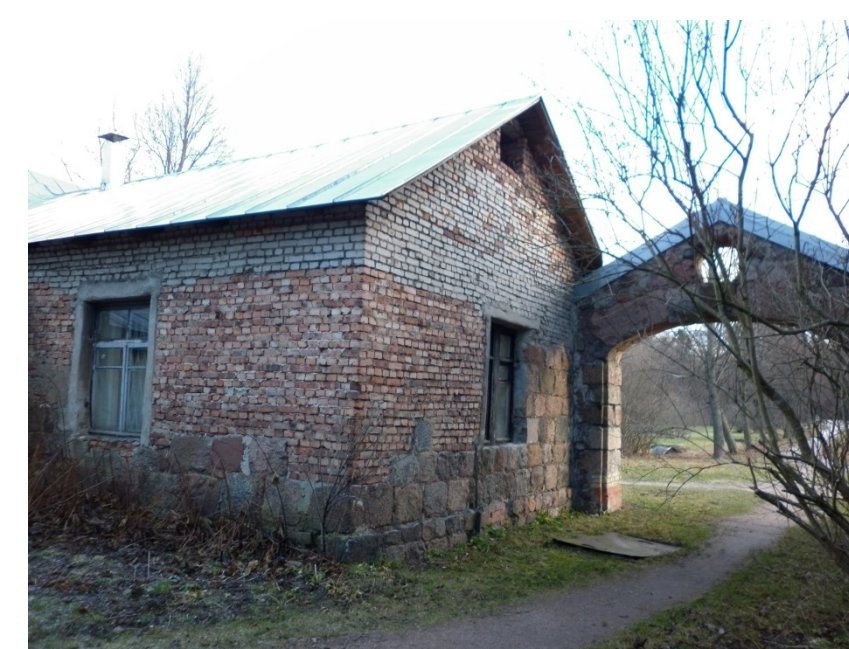
Новая «рыхлая» кирпичная кладка корпуса 10а.
