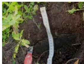
Нарушение технологий при закладке клумб по адресу: Эрлеровский бул., д. Би 8
